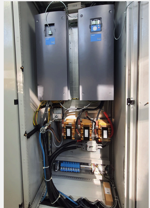
Zdjęcie: System sterowania pompą o mocy 75 kW wykorzystujący przetwornice częstotliwości VACON (Danfoss Drives) i dławiki DC firmy Elhand.
